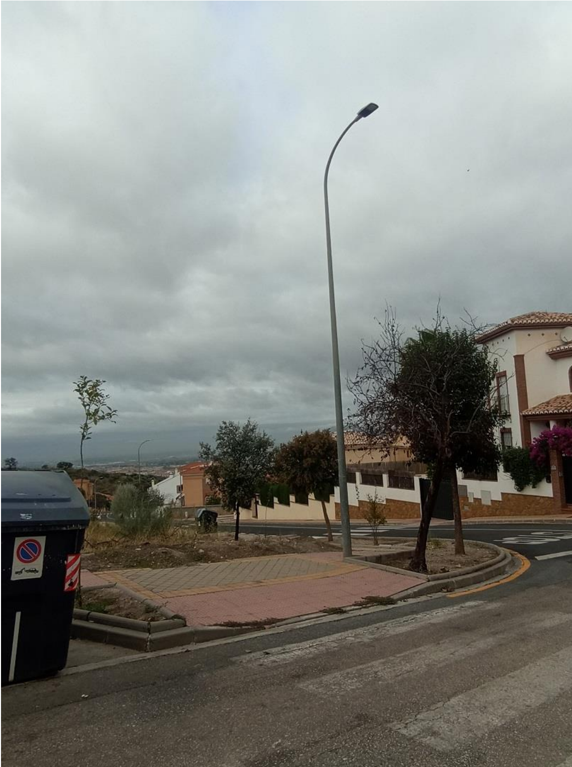
2019/2/EBCAR-260 "JUN, Reforma de alumbrado público exterior para la reducción de emisiones de CO2 en el municipio de Jun". EN EL MARCO PROYECTOS SINGULARES DE ECONOMÍA BAJA EN CARBONO PARA SER COFINANCIADOS MEDIANTE EL PROGRAMA OPERATIVO FEDER DE CRECIMIENTO SOSTENIBLE 2014-2020
