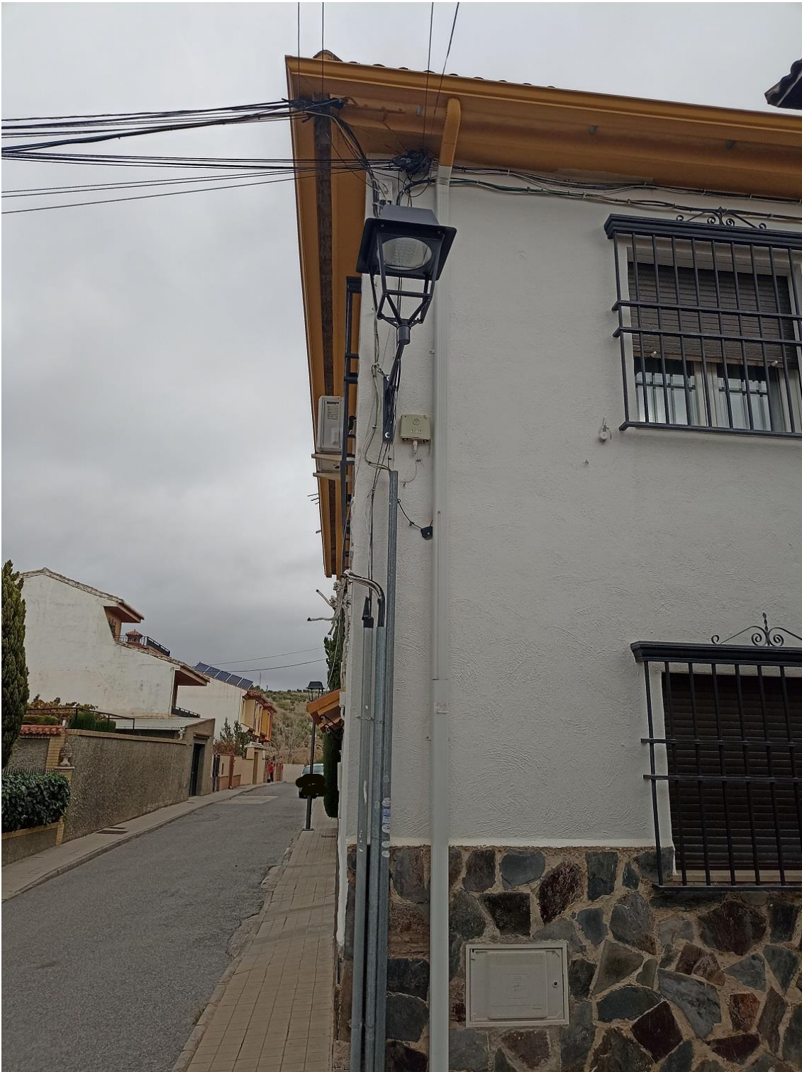
2019/2/EBCAR-260 "JUN, Reforma de alumbrado público exterior para la reducción de emisiones de CO2 en el municipio de Jun". EN EL MARCO PROYECTOS SINGULARES DE ECONOMÍA BAJA EN CARBONO PARA SER COFINANCIADOS MEDIANTE EL PROGRAMA OPERATIVO FEDER DE CRECIMIENTO SOSTENIBLE 2014-2020
