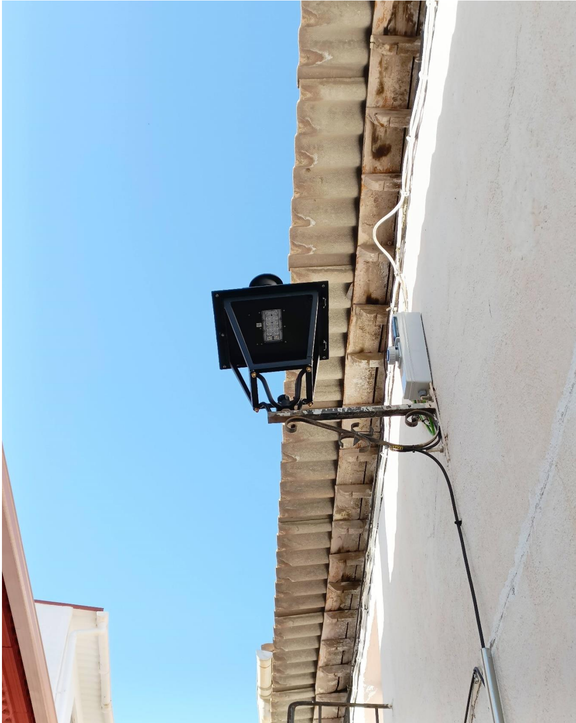
2019/2/EBCAR-52 "FERREIRA, Reducción de emisiones CO2 en el alumbrado público exterior del municipio de Ferreira por aplicación de tecnologías eficientes energéticamente". EN EL MARCO PROYECTOS SINGULARES DE ECONOMÍA BAJA EN CARBONO PARA SER COFINANCIADOS MEDIANTE EL PROGRAMA OPERATIVO FEDER DE CRECIMIENTO SOSTENIBLE 2014-2020
