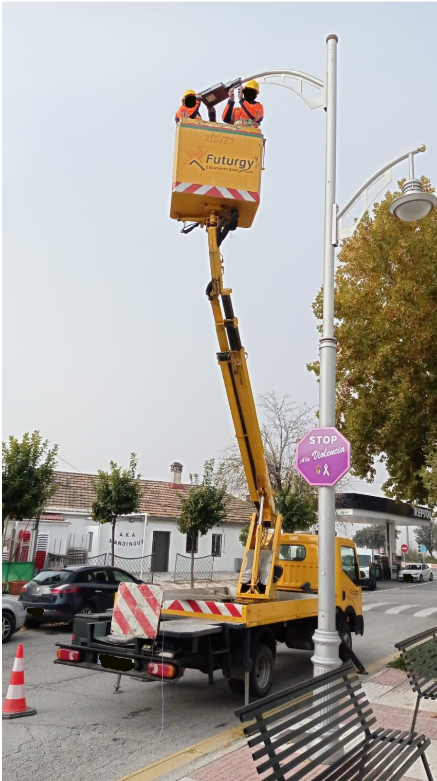
2019/2/EBCAR-280 "PINOS PUENTE, Reducción de emisiones de CO2 en el alumbrado público exterior del municipio de Pinos Puente". EN EL MARCO PROYECTOS SINGULARES DE ECONOMÍA BAJA EN CARBONO PARA SER COFINANCIADOS MEDIANTE EL PROGRAMA OPERATIVO FEDER DE CRECIMIENTO SOSTENIBLE 2014-2020
