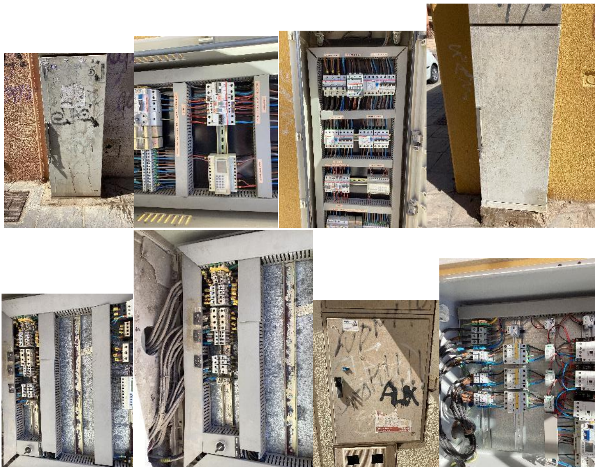
2019/2/EBCAR-300 "SANTA FE, Reducción de emisiones de CO2 en el alumbrado público exterior del municipio de Santa Fe, por la aplicación de tecnologías eficientes energéticamente". EN EL MARCO PROYECTOS SINGULARES DE ECONOMÍA BAJA EN CARBONO PARA SER COFINANCIADOS MEDIANTE EL PROGRAMA OPERATIVO FEDER DE CRECIMIENTO SOSTENIBLE 2014-2020.
