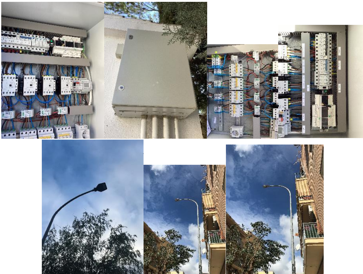
2019/2/EBCAR-300 "SANTA FE, Reducción de emisiones de CO2 en el alumbrado público exterior del municipio de Santa Fe, por la aplicación de tecnologías eficientes energéticamente". EN EL MARCO PROYECTOS SINGULARES DE ECONOMÍA BAJA EN CARBONO PARA SER COFINANCIADOS MEDIANTE EL PROGRAMA OPERATIVO FEDER DE CRECIMIENTO SOSTENIBLE 2014-2020.
