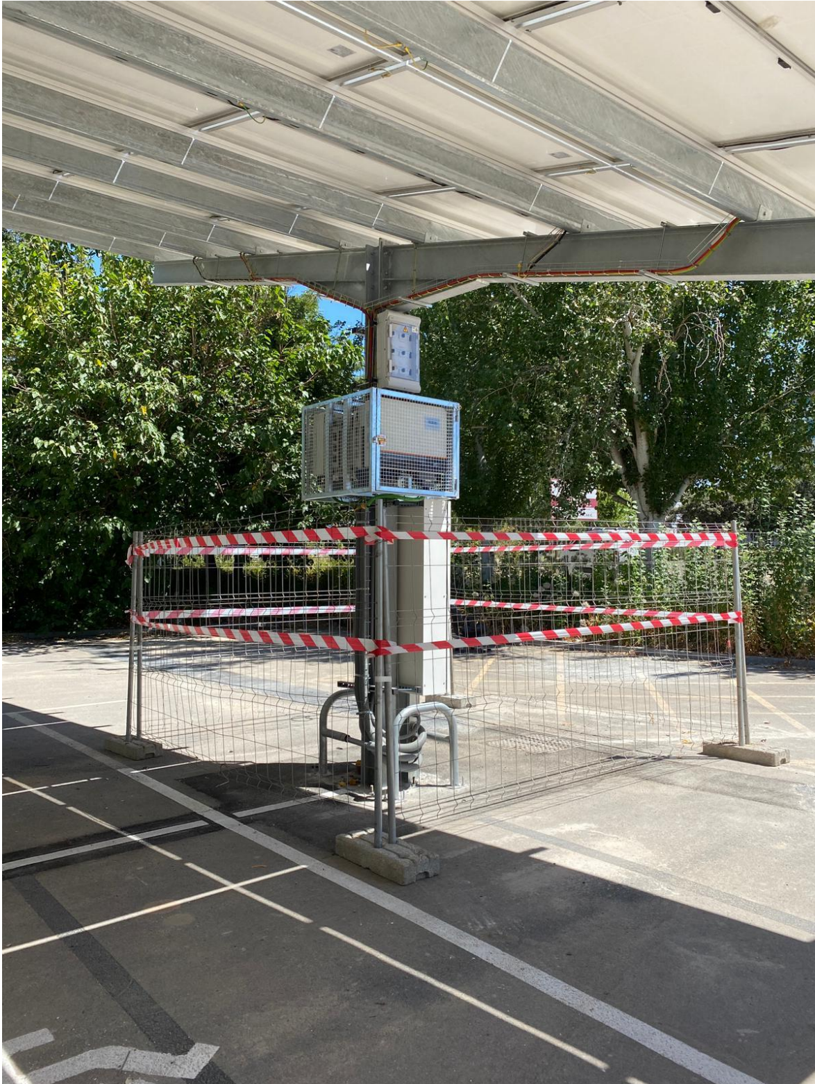
2021/2/REDIP/1-11 "DIPUTACION, Instalación solar fotovoltaica en el Edificio CIE (Centro de Iniciativas Empresariales)". EN EL MARCO PROYECTOS SINGULARES DE ECONOMÍA BAJA EN CARBONO PARA SER COFINANCIADOS MEDIANTE EL PROGRAMA OPERATIVO FEDER DE CRECIMIENTO SOSTENIBLE 2014-2020
