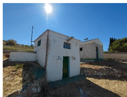
Depósito cloración (El Turro)
