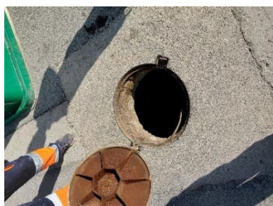
Ubicación válvula reductora (Moraleda Zafayona)
