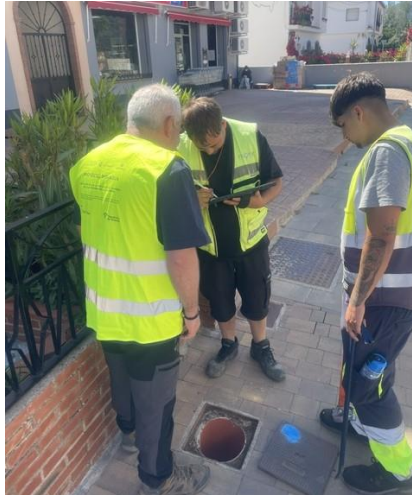
Revisión de las arquetas de abastecimiento. Zafarraya
