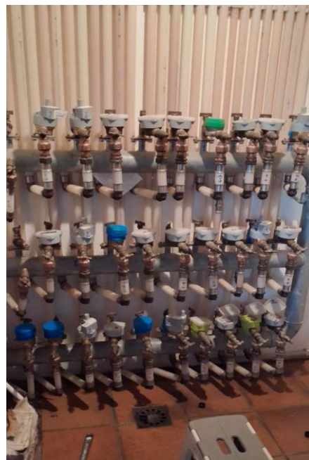
Modificación de batería de contadores en Monachil.
