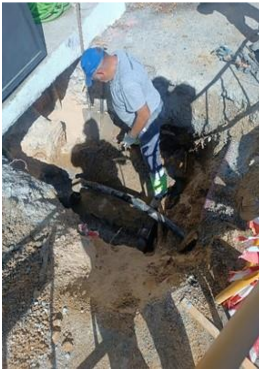
Conexión depósito Huétor Santillán.
