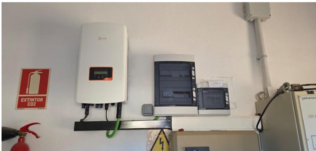
Inversor y cuadros de protección de alterna y continua en la EDAR de Zafarraya.
