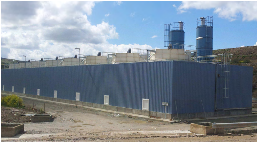
Imagen 3-3: Planta de tratamiento de lixiviados en la Ecocentral, Alhendín.
