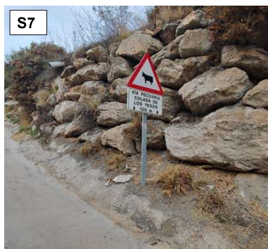
Señal 7. Señalización margen derecho en sentido Sorvilán, de vía pecuaria existente "Colada de los Yesos". Presencia de cuneta en mal estado en este mismo margen.
