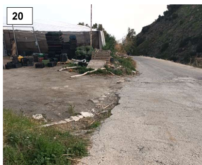
Foto 20. Fotografía tomada en sentido N-340, Acceso a parcela en PK 0+680. Las tuberías de los regantes desaparecen. Inexistencia (al igual que en el tramo anterior) de cuneta en margen izquierdo y de bionda en margen derecho.
