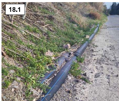
Foto 18.1. Fotografía tomada desde el PK 0+650 en sentido hacia la N-340. Se observa talud en el margen izquierdo desprovisto de cuneta y con presencia en este caso de dos tuberías al borde de la calzada de PE100 PN16 ø160 mm de la comunidad de regantes. La más cercana a la calzada sin servicio ya que se encuentra cortada en un punto.
