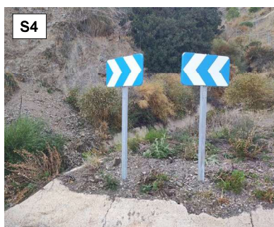
Señal 4. Señalización junto a cuneta trapezoidal PK 0+440
