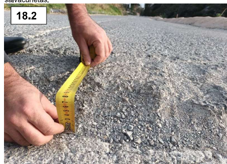
Foto 18.2. Fotografía tomada en sentido hacia la N-340. Presencia de desnivel en calzada con un espesor de 8 cm en PK 0+700 aproximadamente.
