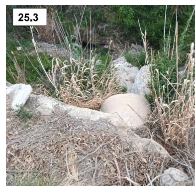
Foto 25.3. salida ODT 2 hacia el Barranco de los Yesos. Tubo de hormigón de diámetro 800 mm
