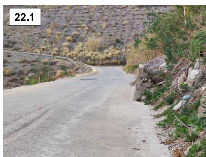
Foto 22.1. Fotografía tomada en el PK 0+730 en sentido hacia Sorvilán. Se observa el muro definido en la Foto 21 que sobresale respecto al firme.
