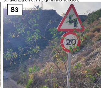
Señal 3. Señalización junto a cuneta trapezoidal PK 0+395
