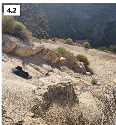
Foto 4.2. Obra de salida ODT1 hacia Barranco de los Yesos. Se observa daños en la tubería pero la obra de salida se encuentra en buen estado.
