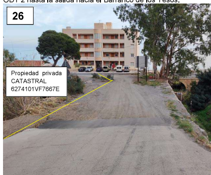
Foto 26. Tramo final que enlaza con la N-340. Inexistencia de cuentas y biondas de protección. Línea amarilla delimita con parcela privada.
