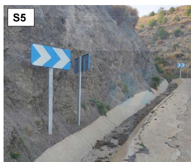
Señal 5. Señalización junto a cuneta trapezoidal PK 0+460
