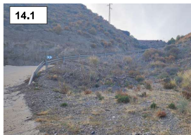
Foto 14.1. Tramo PK 0+400 a PK 0+450, Sentido Sorvilán. Inexistencia de cuneta en este margen.
