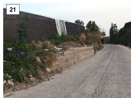
Foto 21. PK 0+680 a 0+710. Fotografía tomada en sentido hacia N-340. Inexistencia de cuneta y presencia de muro de 1,30 metros de altura y 14,60 m de longitud que permite contener las tierras en ese tramo.
