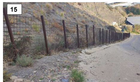
Foto 15. Continuación tramo Foto 14.1 pero en sentido N-340 donde se observa que a partir del PK 0+505 existe una cuneta en el margen izquierdo en sentido N-340. Además existe una malla de protección en este mismo margen y una señal en sentido ascendente a Sorvilán (señal S6)
