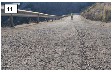
Foto 11. Estado del firme en tramo comprendido entre PK 0+265 y PK 0+400. Cuneta trapezoidal existente en margen derecho y bionda en margen izquierdo
