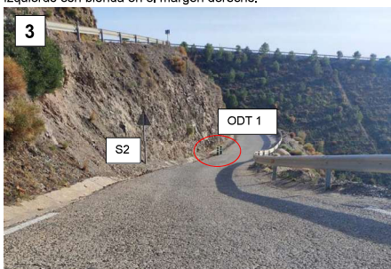
Foto 3. Estado del firme, Cuneta existente margen izquierdo y bionda en margen derecho. Señal 2 (S2) en sentido Sorvilán y ODT1 existente
