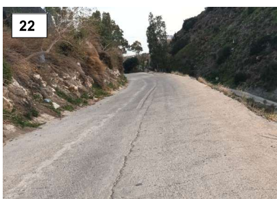
Foto 22. Fotografía tomada en el PK 0+730 en sentido hacia N-340. Inexistencia de cuneta en margen izquierdo ni bionda en margen derecho. Talud con piedras de gran tamaño en margen izquierdo.
