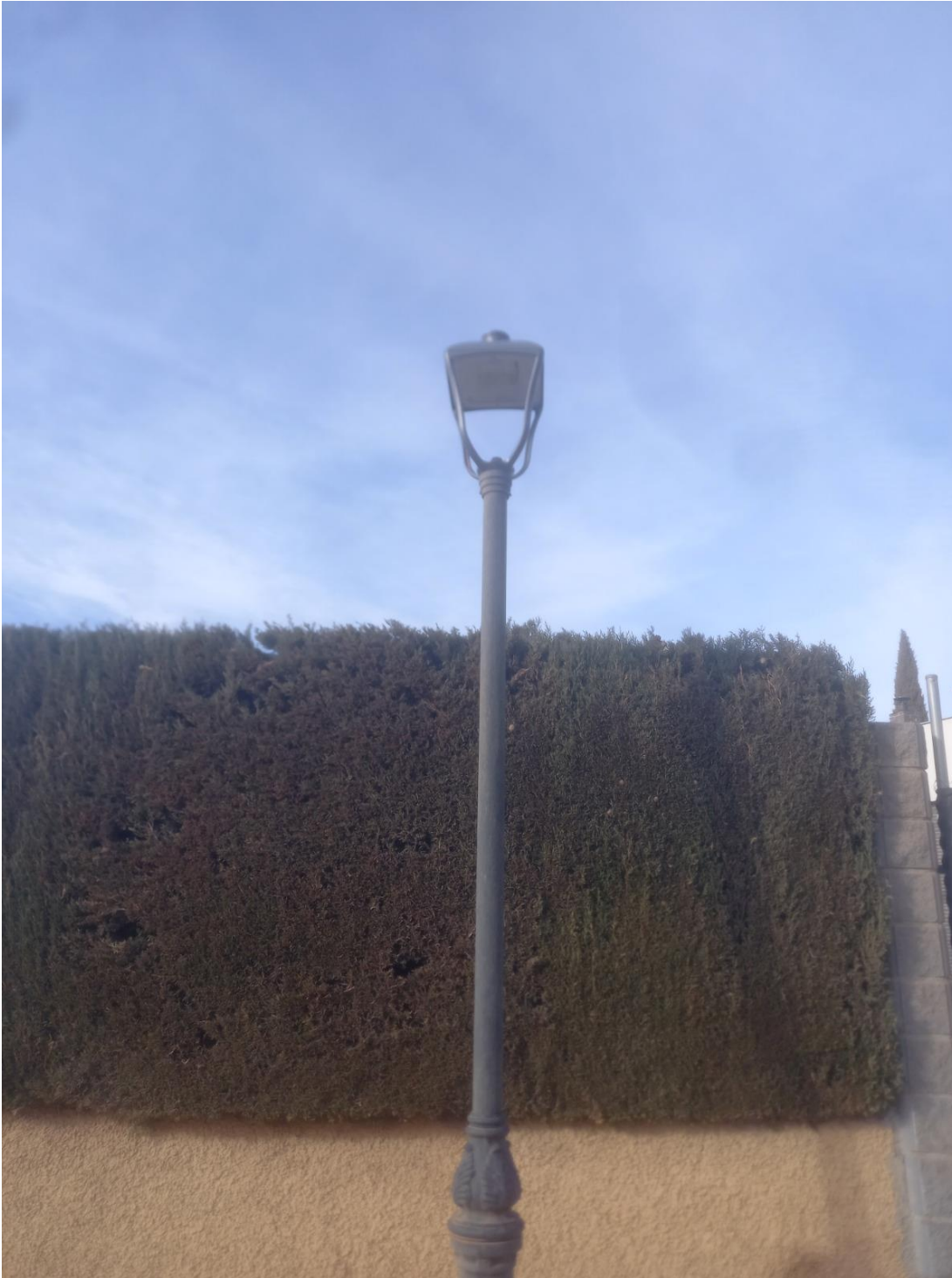
2019/2/EBCAR-160 "HUÉTOR SANTILLÁN, Reducción de emisiones de CO2 en el alumbrado público exterior del municipio de Huétor Santillán". EN EL MARCO PROYECTOS SINGULARES DE ECONOMÍA BAJA EN CARBONO PARA SER COFINANCIADOS MEDIANTE EL PROGRAMA OPERATIVO FEDER DE CRECIMIENTO SOSTENIBLE 2014-2020
