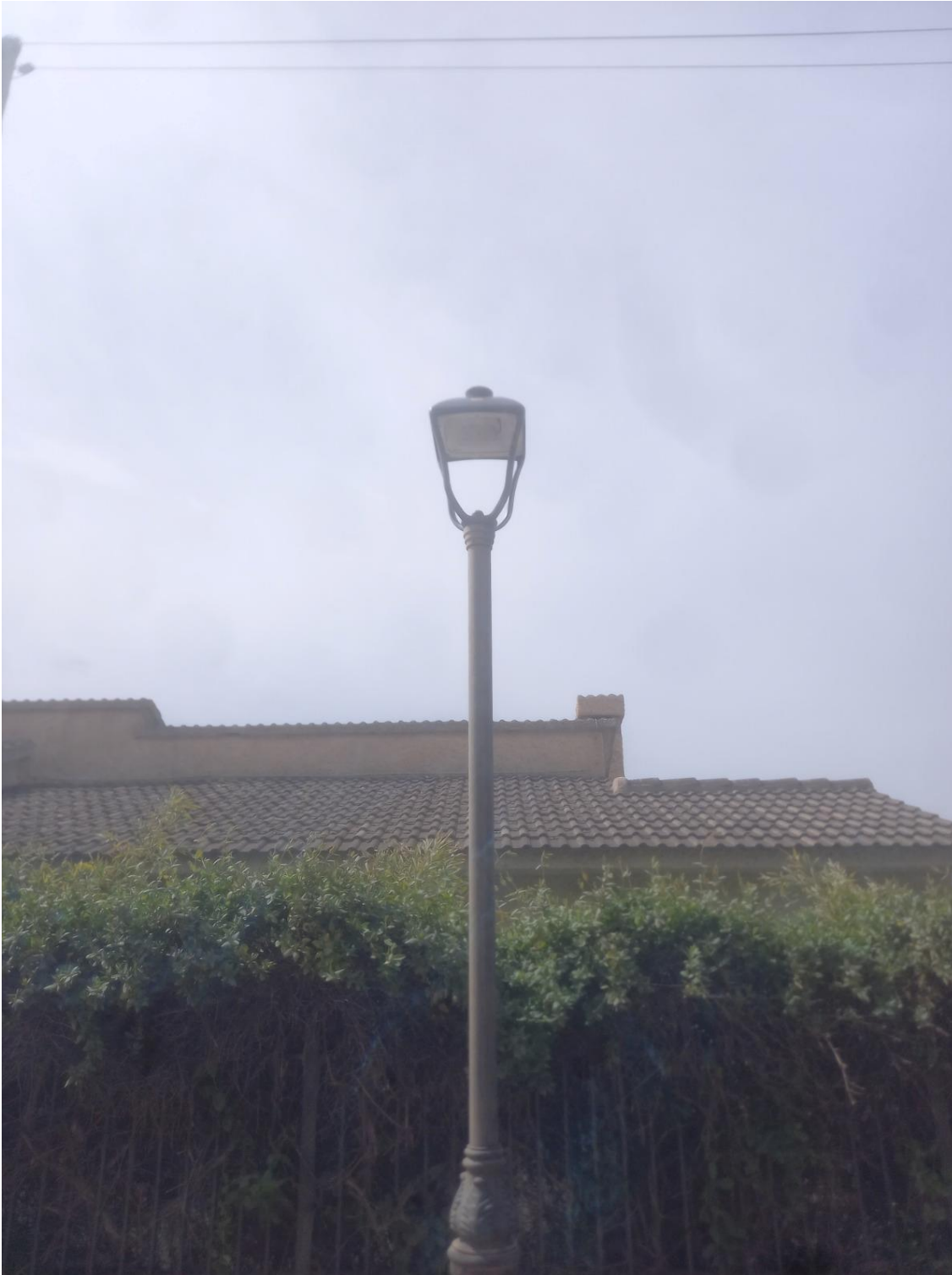
2019/2/EBCAR-160 "HUÉTOR SANTILLÁN, Reducción de emisiones de CO2 en el alumbrado público exterior del municipio de Huétor Santillán". EN EL MARCO PROYECTOS SINGULARES DE ECONOMÍA BAJA EN CARBONO PARA SER COFINANCIADOS MEDIANTE EL PROGRAMA OPERATIVO FEDER DE CRECIMIENTO SOSTENIBLE 2014-2020
