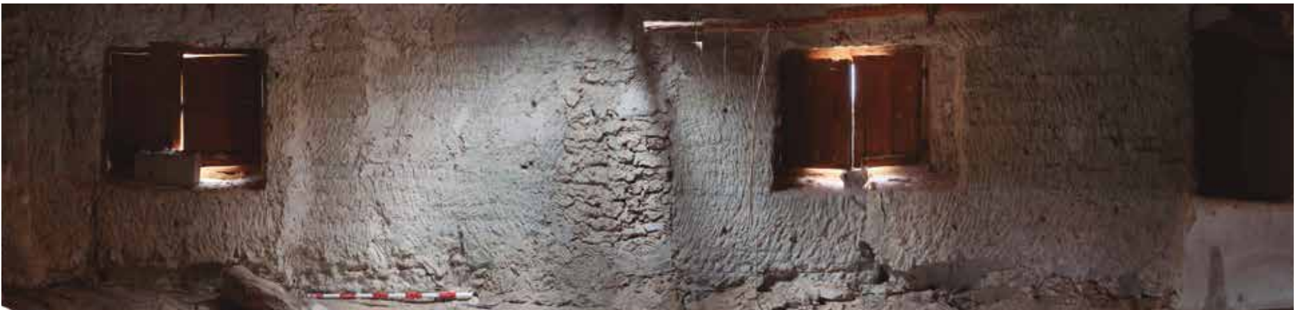
Figura 7. Restos de tapial en la parte interna de la fachada oriental de la casa.
