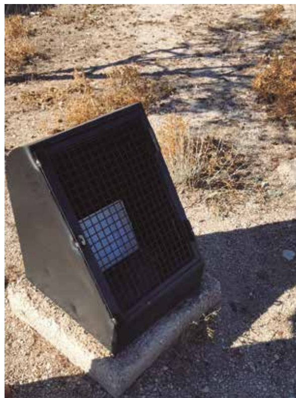
Dispositivo de iluminación.
