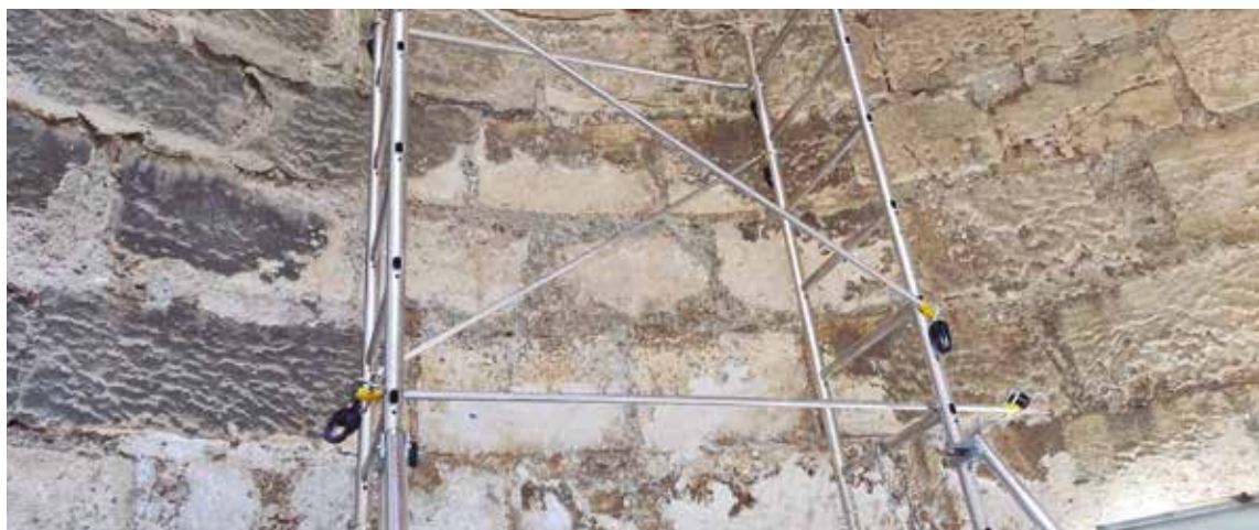
Cata de limpieza de las costras calcáreas de los sillares
