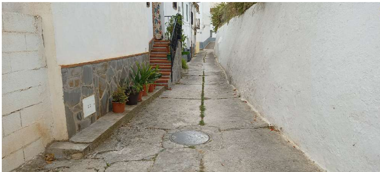
ESTADO ACTUAL DE LA PAVIMENTACIÓN
