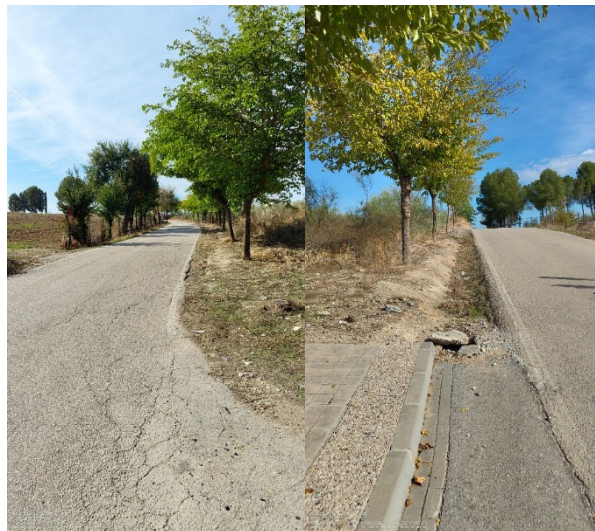
Estado actual pavimento, señalización
