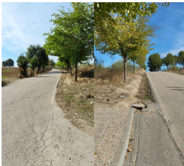
Estado actual pavimento, señalización
