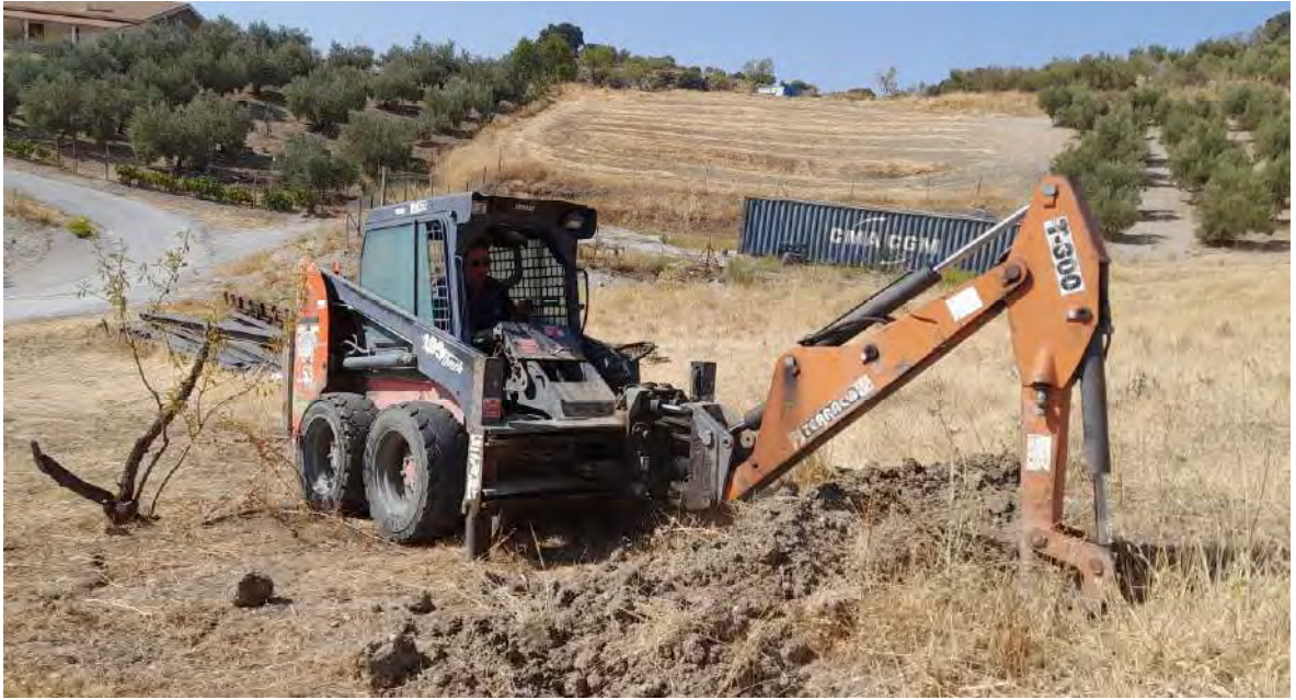
Figura Nº 5.- Fotografía de la ejecución de la calicata referida en este documento como C-01.
