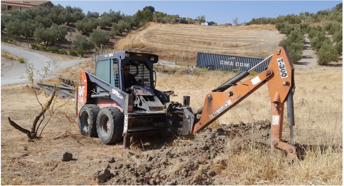
Figura Nº 5.- Fotografía de la ejecución de la calicata referida en este documento como C-01.
