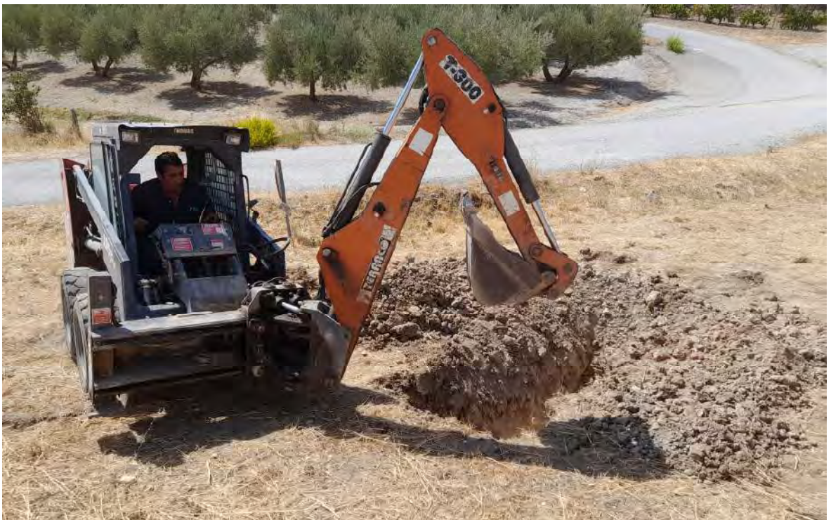
Figura Nº 6.- Fotografía de la ejecución de la calicata referida en este documento como C-02.
